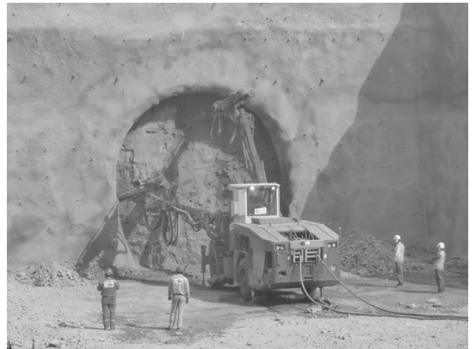
Figura 3: Control de perforación Jumbo DT820
